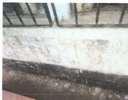
Foto 6: Pintura en mal estado
